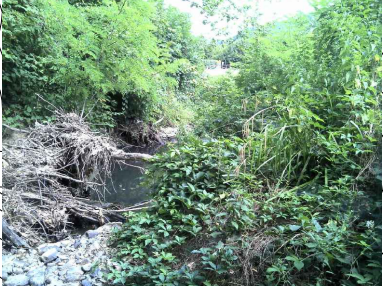
Stazione 10/1 Piante schiantate in alveo e presenza di erosione del fondo alveo
