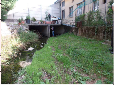
Stazione 10/4 Sovralluvionamento alveo a monte tombinatura ditta CoVer.Lac
