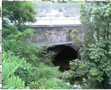
Stazione 15/1 Vegetazione ed erosione in alveo a monte Strada Provinciale 66
