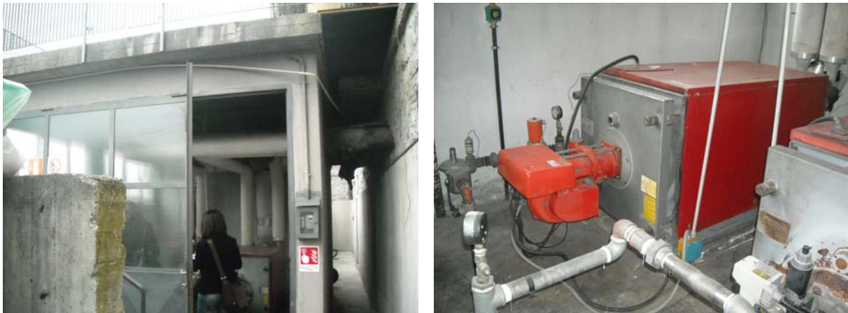
Fig. 2 Momenti di rilievo in centrale termica.
